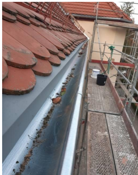
„ Naprawa pasa przyrynnowego dachu pokrytego dachówką wraz z wymianą opierzenia, rynien dachowych i spustowych oraz zamontowanie płotka przeciwniegowego na bud. „A” za kwotę 65.190,00 zł
